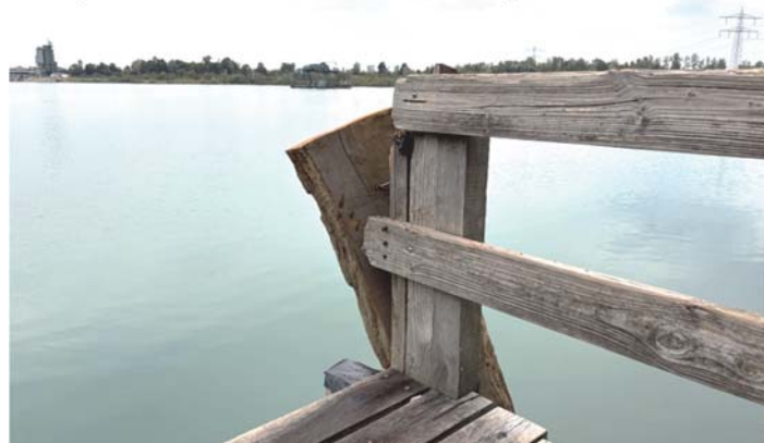
Der offensichtlich mutwillig beschädigte Steg am Baggersee.
