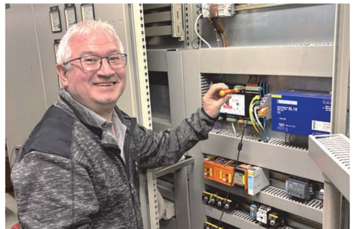
Betriebsleiter Daniel Kuderer testet bei der neuen Anlage
